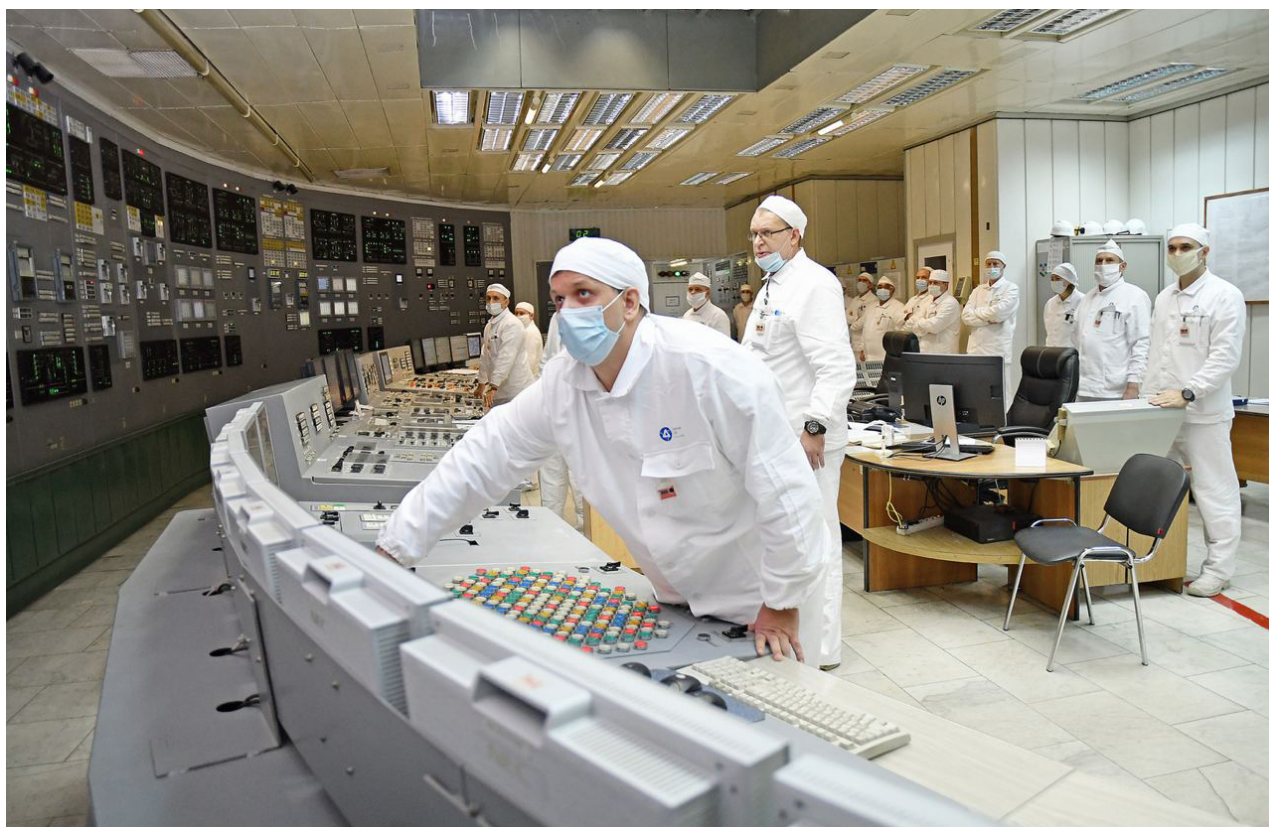
Окончательный останов первого блока Курской АЭС с реактором РБМК-1000 после 45 лет работы 19 декабря 2021 года
